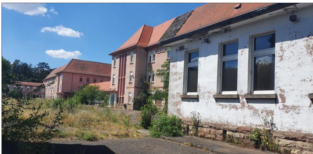
A cause des infiltrations, une partie du bâtiment est en mauvais état. Photo RL/Jonathan BREUER
